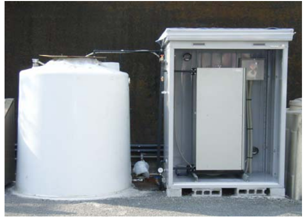
逆浸透膜法による RO 水発生装置と貯留タンク
